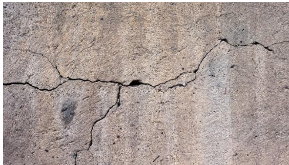
Fissure sur un bâtiment
